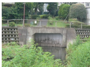
越流水放流渠 きよ （世田谷区）
